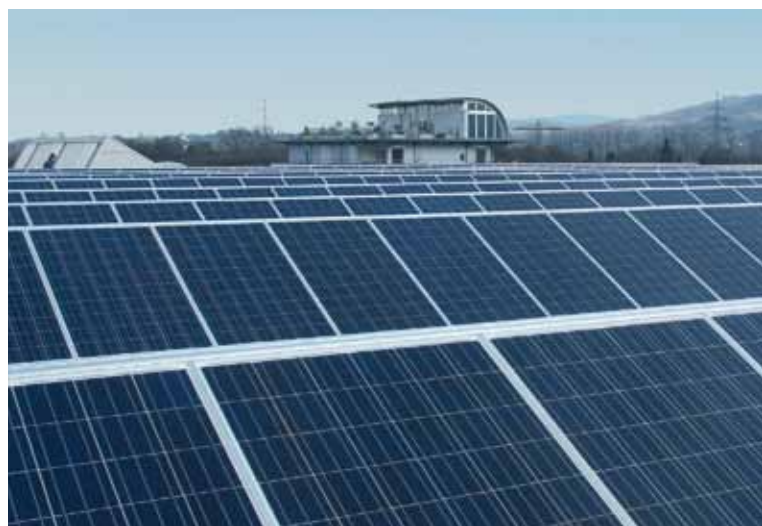
Made by Mega Solar: die Photovoltaikanlage auf dem Dach der Firma Peter Huber Kältemaschinenbau in Offenburg-Elgersweier
